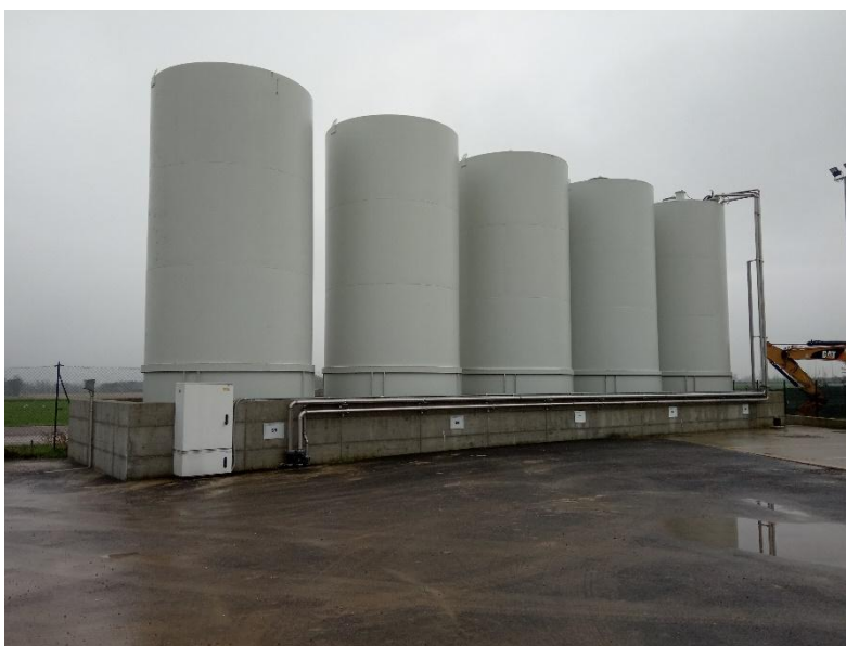
Silos di accumulo del percolato
